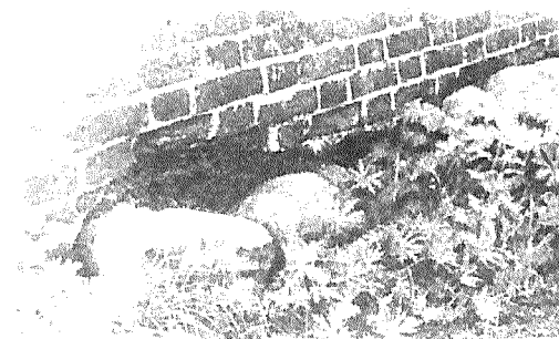
Рис. 37. Деформация валунного фундамента в результате промерзания и оттаивания глинистых грунтов основания
